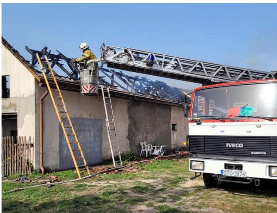
Fot. Pożar budynku w Krasiejowie.
